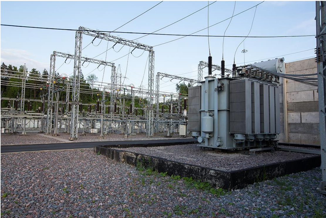
Демонстрационный стенд представляет собой симуляцию инфраструктуры объекта понижающей (трансформаторной) подстанции 110/10кВ
